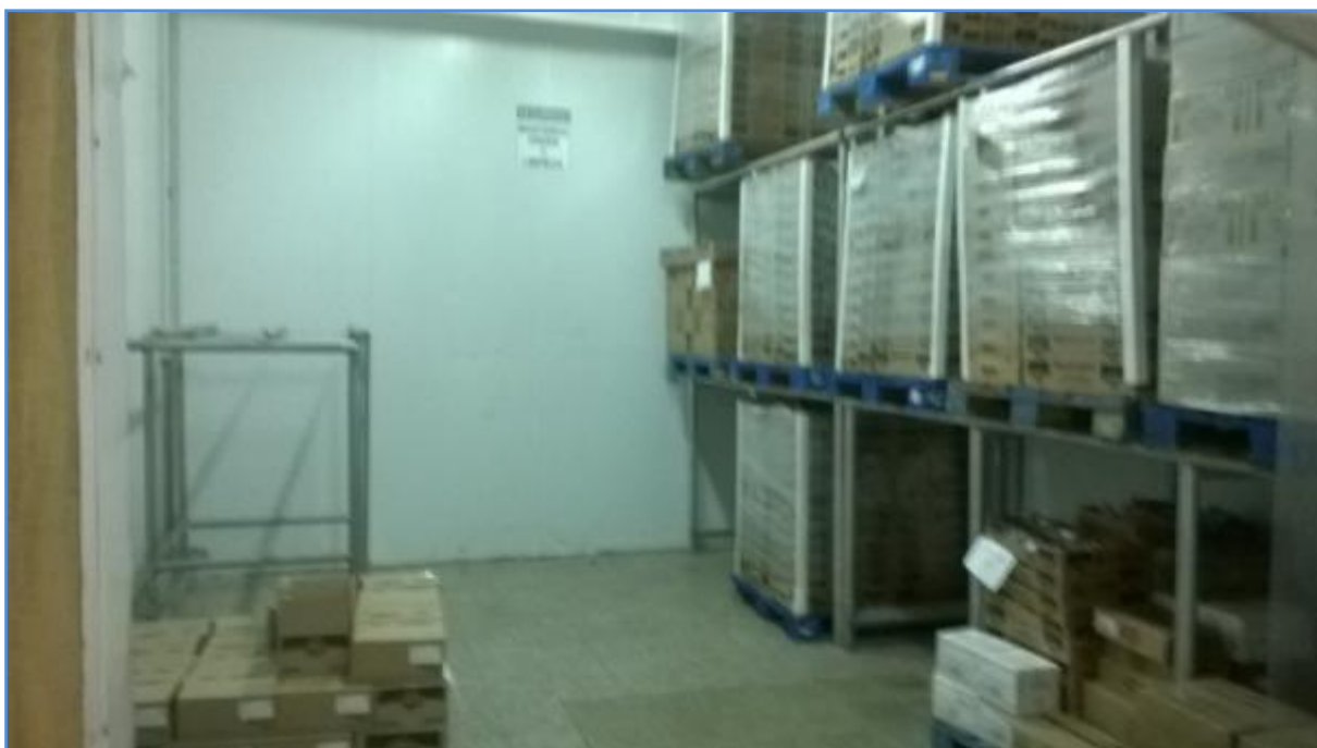
Secadero: trabaja entre 6° y 14° de temperatura
