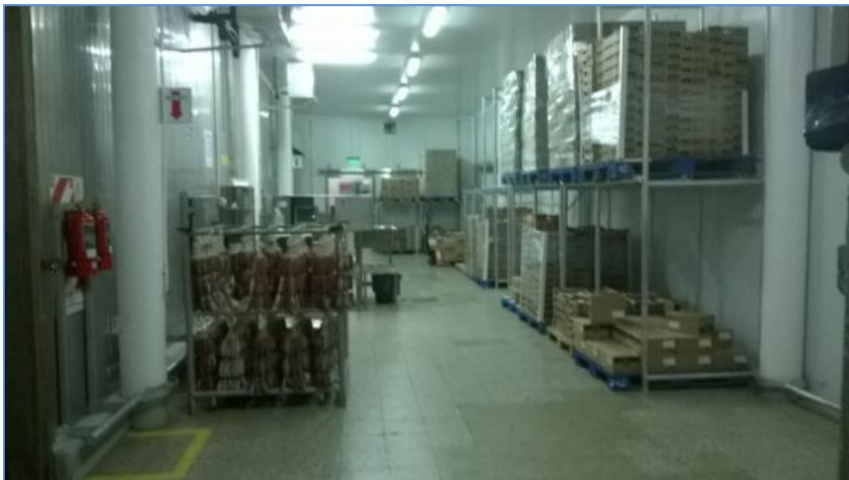
Cámara para Picking: trabaja entre 0° y 5° de temperatura
