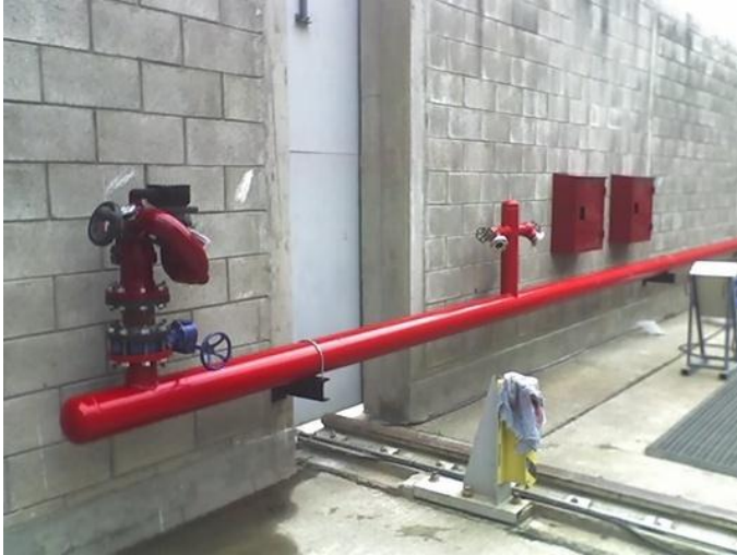
Imagen ilustrativa 17: Tuberías sistema hidrante sobre pared.
