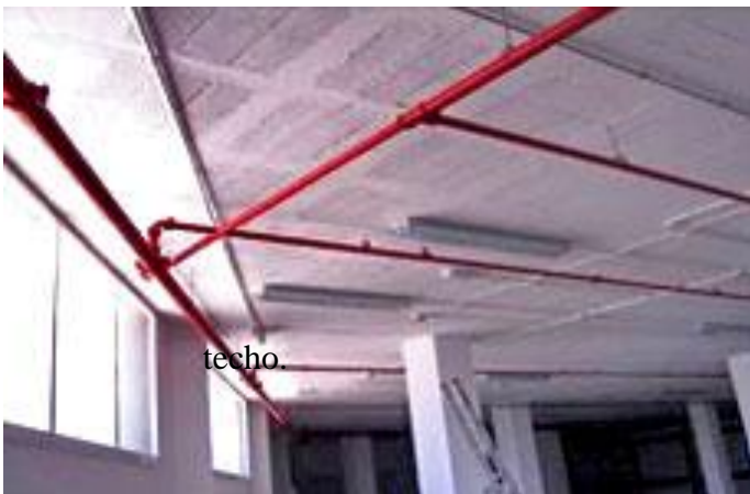
Imagen ilustrativa 16: Tuberías sistema hidrante sobre
