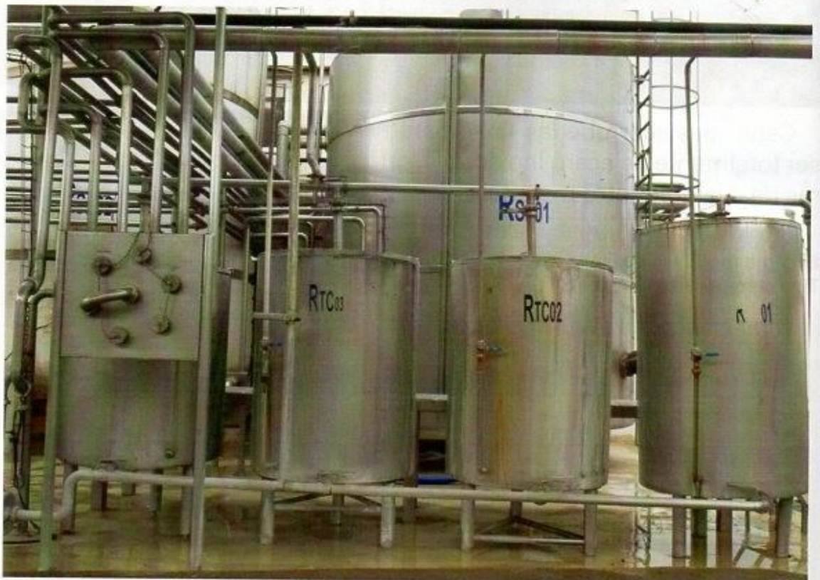
Tanques y cañerías para limpieza. C.I.P.
