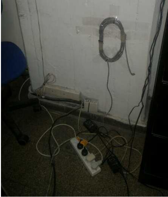
Instalaciones eléctricas y cables en el medio del paso sin resguardo. Riesgo de tropiezos, caídas y cortocircuitos.
