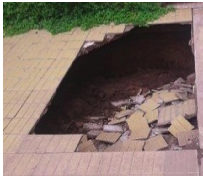
Vereda desplomada en el centro de la ciudad de Monte Maíz
