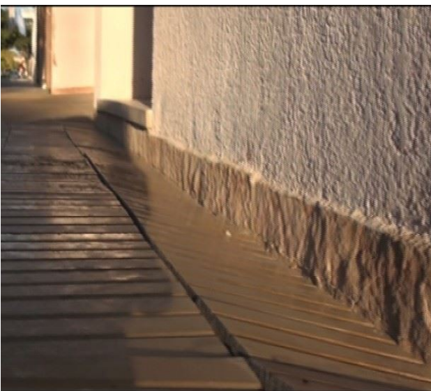
Hundimiento de los cimientos de una casa.
